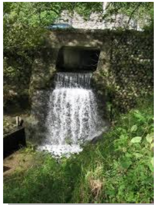
昭和電工排水口
